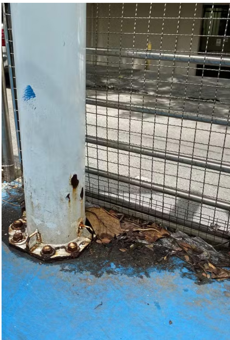
Vigas de sustentação e brinquedos apresentam sinais de ferrugem na Praça Dom Navarro, em Icaraí — Foto: Filipe Bias
